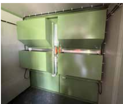
Zuluftöffnungen mit elektrischen Jalousienklappen serienmäßig
