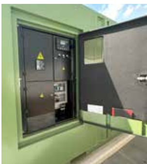
Übersichtliches Bedienfeld hinter versperrbarer Tür mit Sichtfenster
