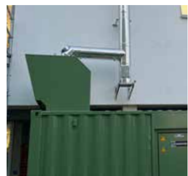
Abluftkanal mit Luftumlenkung seitlich für optimalen Witterungsschutz (demontierbar)
